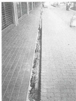
写真-3 建築物廻りの陥没
