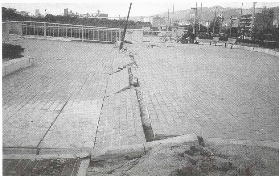
写真-2 液状化による被害状況 (湿式施工)
