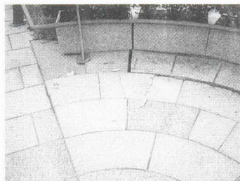
写真-5 クラック(割れ)
