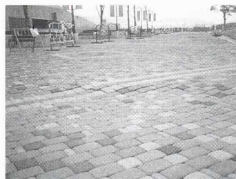
写真-6 沈下(局部)
