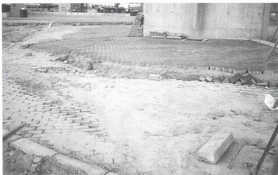
写真-1 液状化による被害状況 (ILB舗装)
