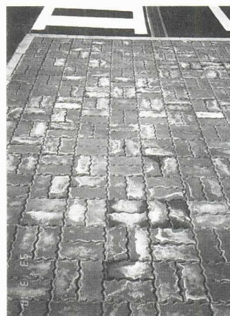
写真-3 2次エフロ(日陰、アスファルト路盤、排水処理なし)
