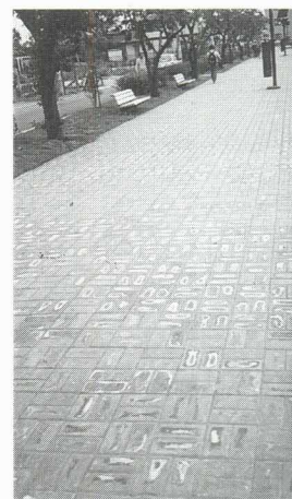
写真-4 コンクリートに発生したエフロ
